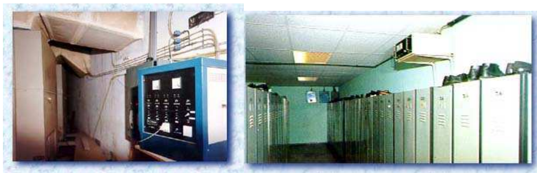
Ozonización de un cine a través del aire acondicionado.
