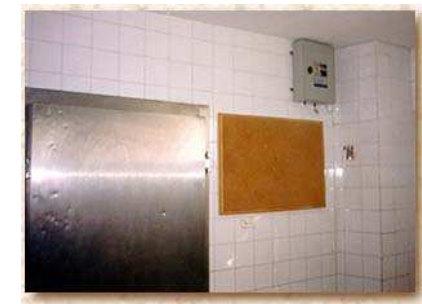
Conservación de alimentos (carne y embutidos) en una cámara frigorífica.
